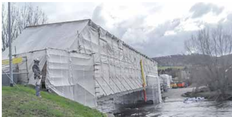
Mit einem Hängegerüst samt Einhausung sind starke Strömungen des Flusses kein Problem.
